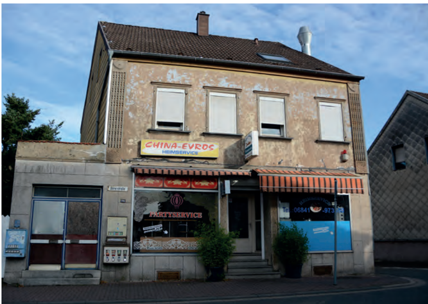
Sanierungsbedürftige Bausubstanz im Bereich der Dürerstraße
