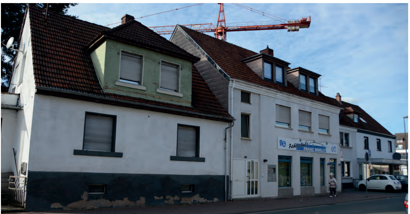
Bausubstanz im Bereich der Dürerstraße mit Modernisierungs- und Instandsetzungsbedarf
