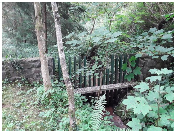
Abbildung 4-70: Geschwemmselgung vor dem Einlauf Höhe Heimbachstraße
